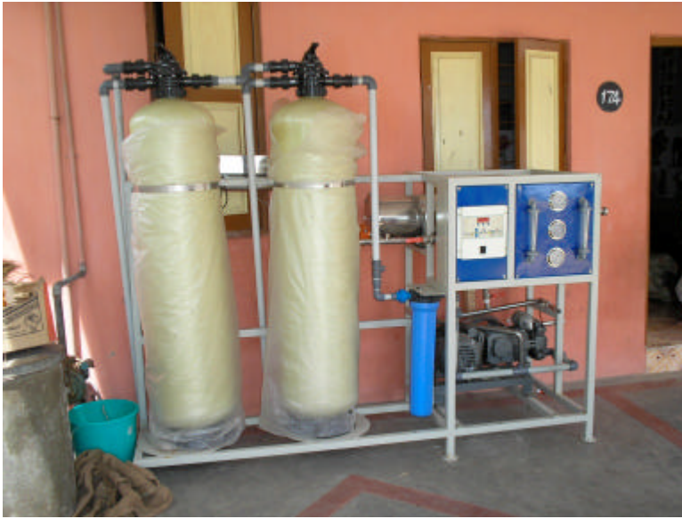
Reverse Osmosis Water treatment plant Osmose-Wasseraufbereitungsanlage
